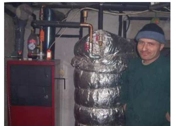
Dieser Familienvater ist glücklich über den gebrauchten, aber funktionierenden Heizkessel
